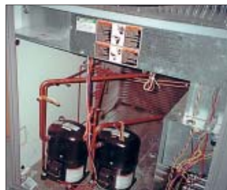
Sprężarki typu „Scroll” z elementami układu chłodniczego
