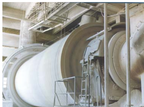
W kruszarkach i młynach zmiany obciążenia są nieregularne i bardzo gwałtowne. Napęd wektorowy, dzięki wysokiej dynamice zapewnia prawidłowy przebieg procesu rozdrabniania.
